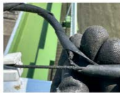
・7月17日（水）北琴平町 （窪川高校） 屋上の引留位置でかじられた ような傷で断線。
